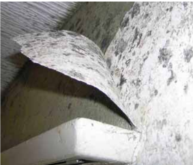
Figure 2: Contamination par des moisissures sur le et le crépi se trouvant en dessous (contamination des couches sous-jacentes).
